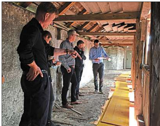
Einsturzgefahr wegen morscher Balken: Der sogenannte Wehrgang ist eines der Sorgenkinder auf der Burg. Hier wird er von verantwortlichen Planern und Bürgermeister Andreas Bratzdrum (Zweiter von rechts) begutachtet.
