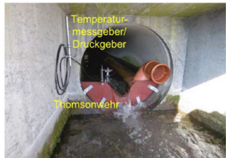
Abbildung 2-3: Installation von Messeinrichtungen zur Erfassung von Drainagewassertemperatur und Durchflussmenge am Tunnel Rennsteig
