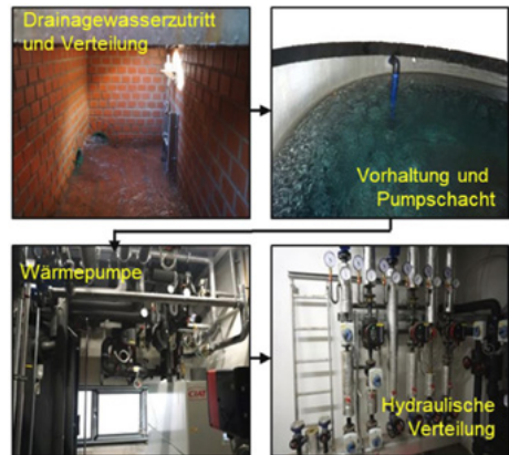
Abbildung 2-4: Pilotanlage am Tunnel „Rennsteig“: Nutzung des am Portal Nord anfallenden Drainagewassers zur Heizung und Kühlung der Technikräume
