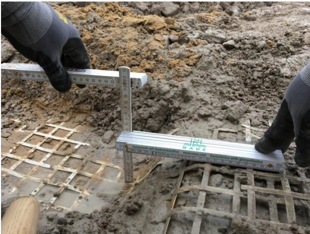
Abbildung 8: Versatz von ca. 10 cm des Geogitters in der oberen Lage im Randbereich der Kranmatte
