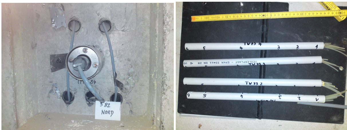
Abb. 4.10: Linke Seite: Aussparung in der Laibung der Tunnelinnenschale für eine Temperaturmesslanze. Dargestellt ist hier die nach Norden zeigende rund 10 m lange Messlanze im Block 82. Die im Bild sichtbaren Leitungen der drei Messlanzen wurden über Hüllrohre im Beton geführt, durch den Kabelkanal auf dem Notgehweg zur Verteileraussparung geleitet und dort zunächst mit einem Datenlogger verbunden. Die seitlichen Kabel gehören zu den beiden anderen Messlanzen. Die Thermistorenketten sind durch das Verschließen der Messlanze mit Dämmstoff gegen das Einströmen von Luft geschützt, die die Messwerte verfälschen könnte. Rechte Seite: Temperaturmessfühler (PT 100), vorbereitet für den Einbau in die Tunnelwand.
