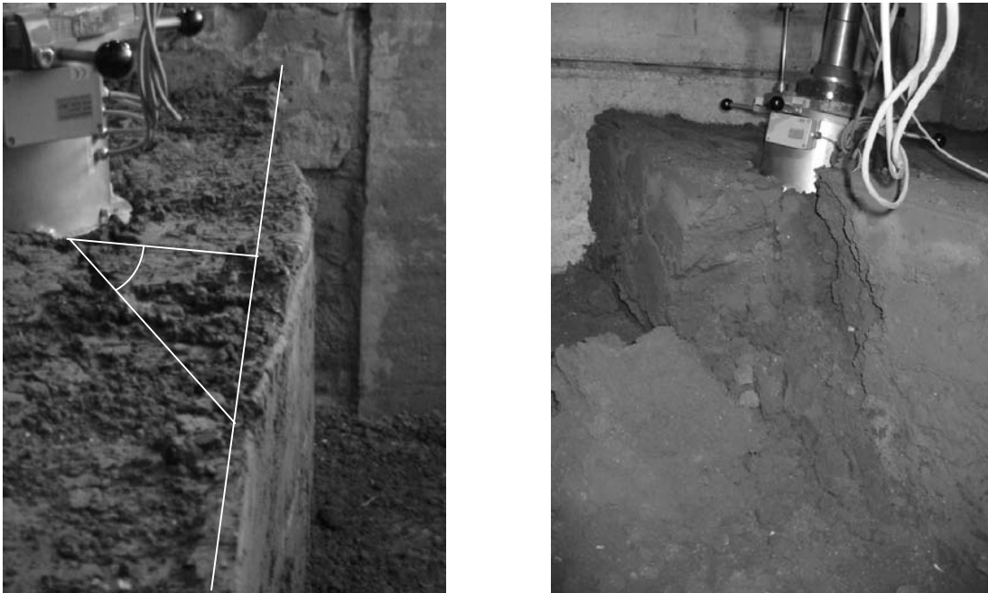
Bild 5.12 Senkrechte Böschungen im Lösslehm mit lokaler Verformung im Bereich der Lastfläche der Böschung (links) und herausgebrochener Bodenblock mit verkippter Lastplatte (rechts)
