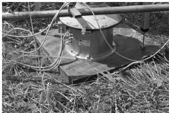
Bild 6.12 Ausgefahrenes Stützbein mit einer Abstützplatte aus Kunststoff auf der Auffüllung aus Lösslehm (Versuchsserie VII)
